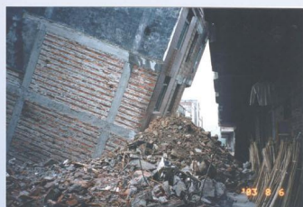
阳江市大河水库移民安置区岩溶塌陷造成楼房倒塌
