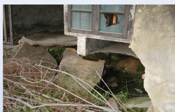
廉江岩溶地面塌陷毁坏民房
